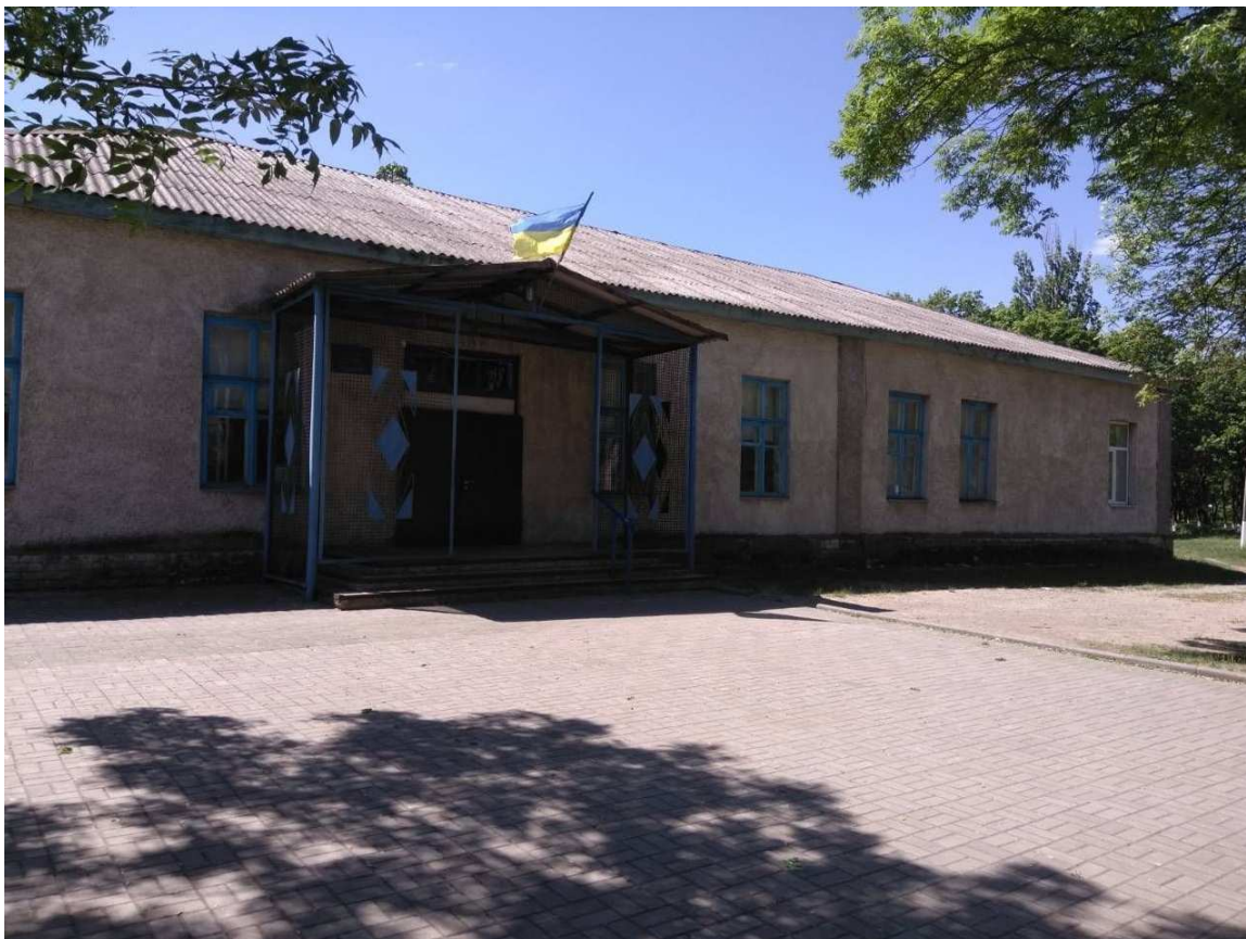
ЦКД с.Рубці до ремонту
